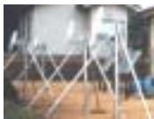
通信用アンテナ
